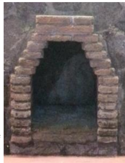
10. Obertures de ventilació que s'intercalen en el sòcol paredat. Actualment, es troben en desús.
