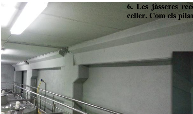
5. Elements portants de l'estructura: pilars amb cartel·les que suporten jàsseres també amb cartel·les. Finalment trobem les planxes de formigó prefabricat.
