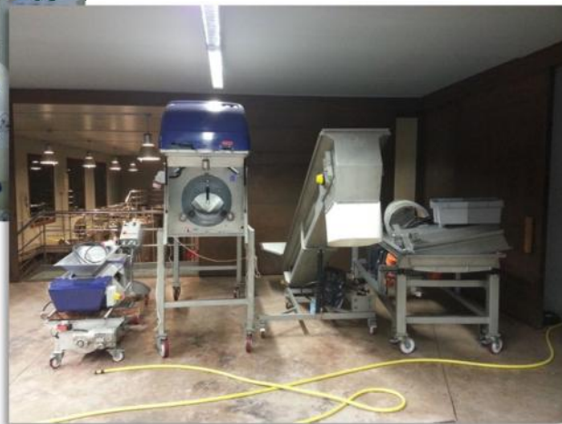
3. Moll de recepció del raïm equipat amb la maquinària necessària per als primers estadis de la producció.
