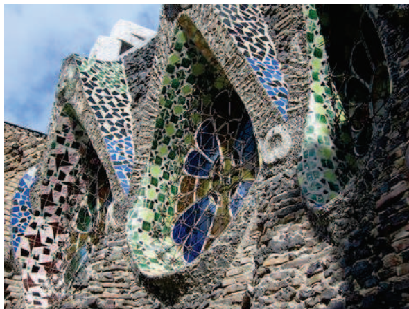
Mur de paraboloides hiperbòlics de tancament de la Cripta de la Colònia Güell.
