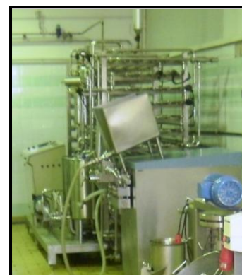
Figura 11: Maquinària necessària per la pasteurització de l'UAB
