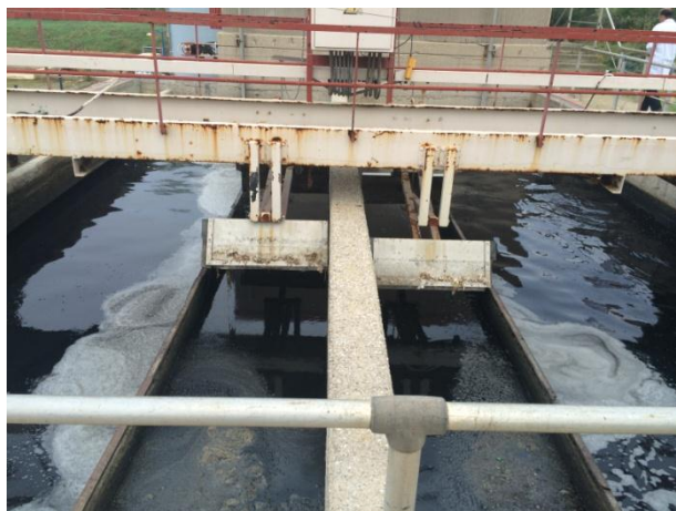
(4) Canal dessorador-desgreixador. Pretractament.
