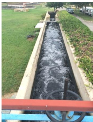
(5) Canal Parshall. Pretractament.
