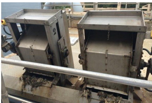
(1) Reixes automàtiques de desbast a l'entrada de l'EDAR. Pretractament.
