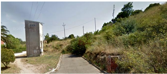
Imatge 24: Estació transformadora terciària.
