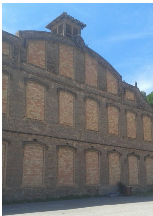
Fàbrica de Cal Riera amb les finestres tapiades
