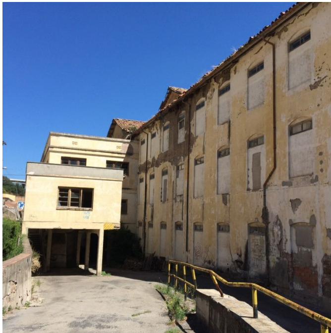
Fàbrica de Cal Rosal. La nau, de pisos, està en molt mal estat
