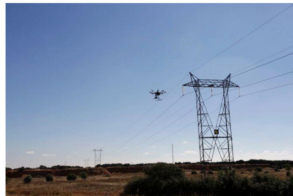
Figura 33 Dron en la inspecció de xarxes elèctriques Font: energiacastillayleon.com
