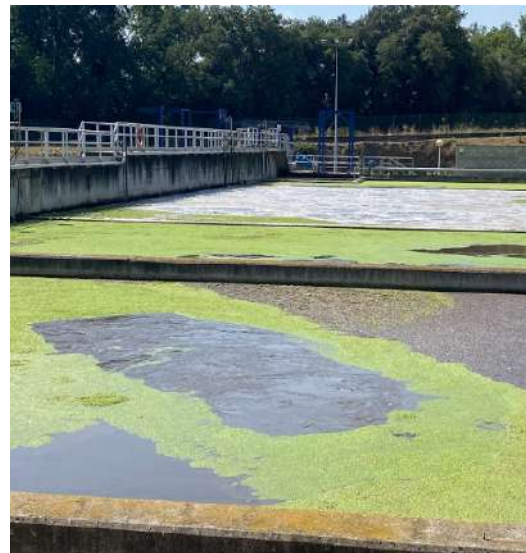
Figura 23: Decantadors (Imatge pròpia)
