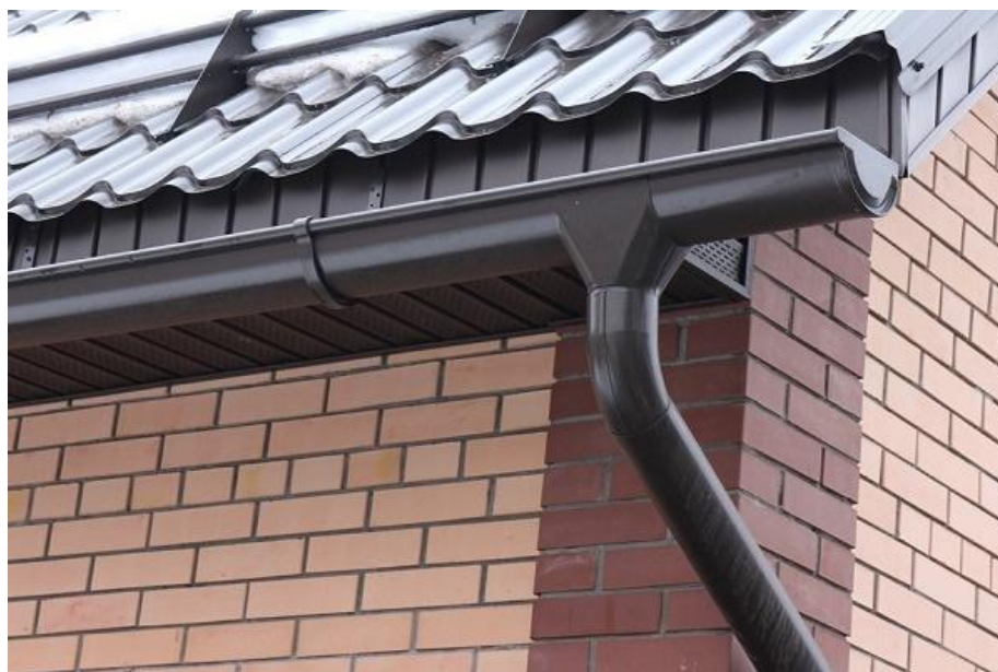
Figura 8. Canalitzacions d'aigua pluvial a les teulades.
