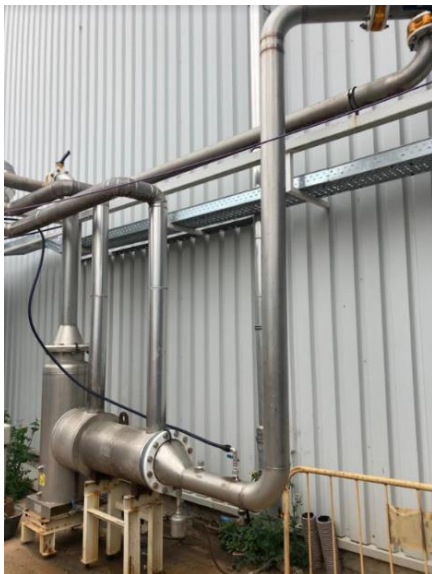
Figura 13: sistema d'escalfament del digestor.
