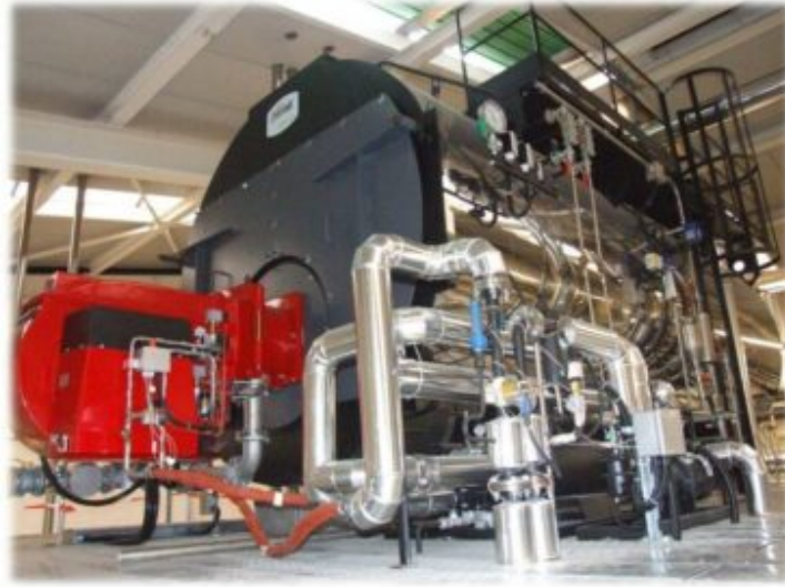
Imatge 20. Caldera de fluid tèrmic
