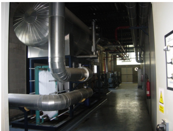
Fig.5.6. Sistema refrigeració, cambres frigorífiques
