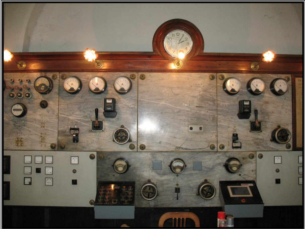
Antic panell de control de la central de Vilanna. Actualment està completament en desús (la central està totalment automatitzada). Si pot observar un rellotge que tampoc funciona, uns panell de posta en marxa i aturada de la central, i dos panells idèntics per controlar i recollir les dades de les dues turbines. (Font: Elaboració pròpia)
