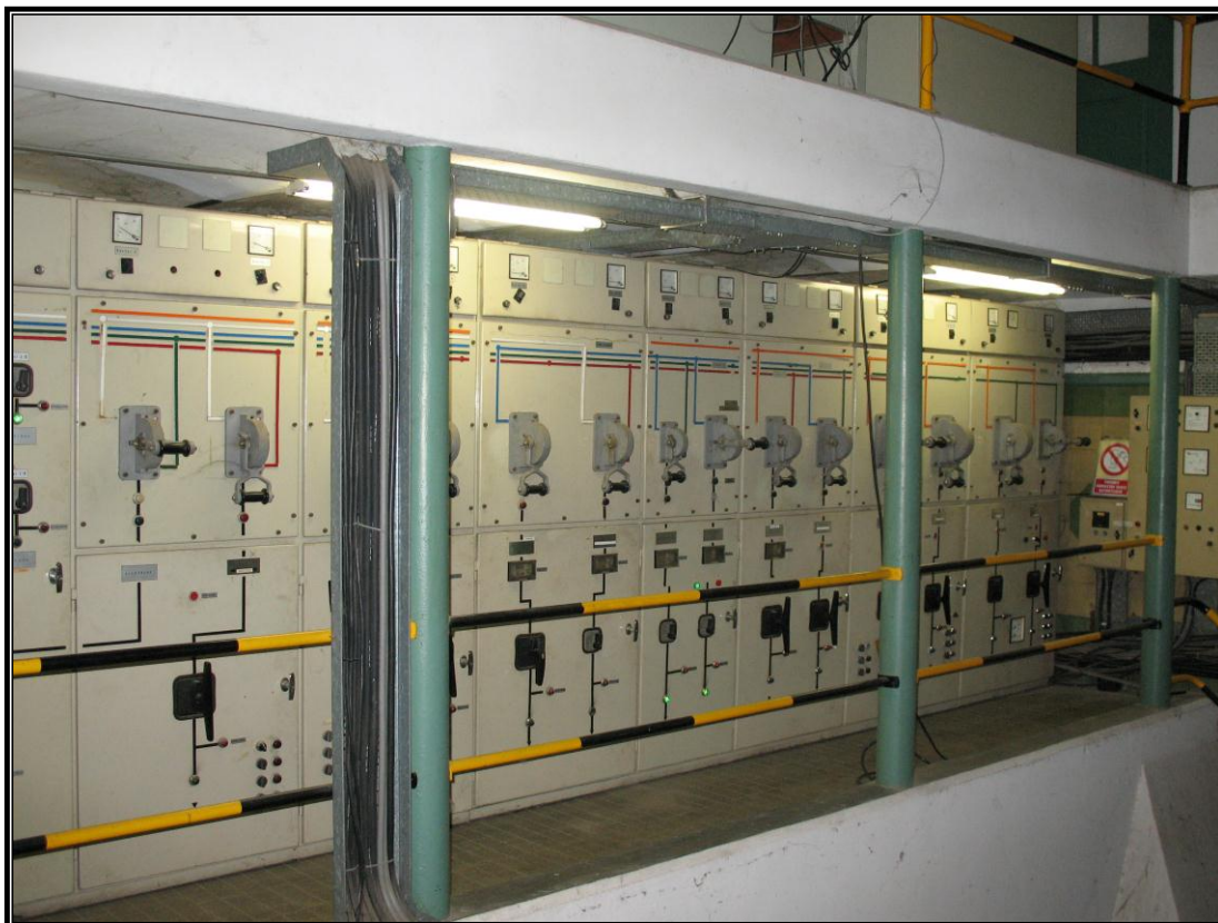
Imatge corresponent a uns panells de control de la central. Aquests permeten una gran quantitat d'opcions de funcionament. Està situat al costat de la turbina 2 (Francis)
