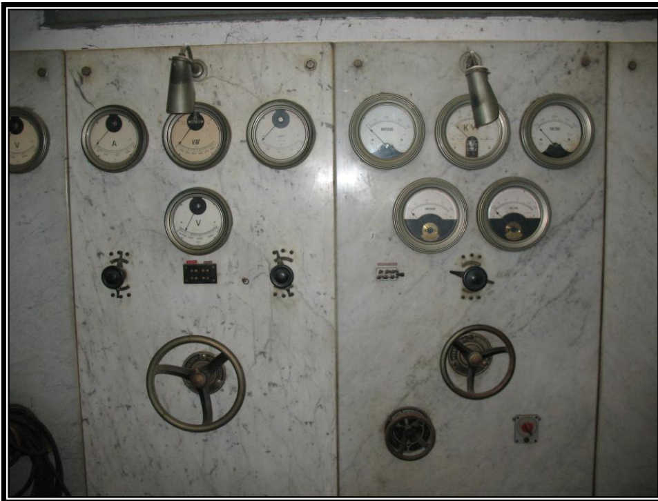
Antic panell de control de la central del Turó dels Cavalls. Presa a la sala de les turbines. (Fotografia d'elaboració pròpia)
