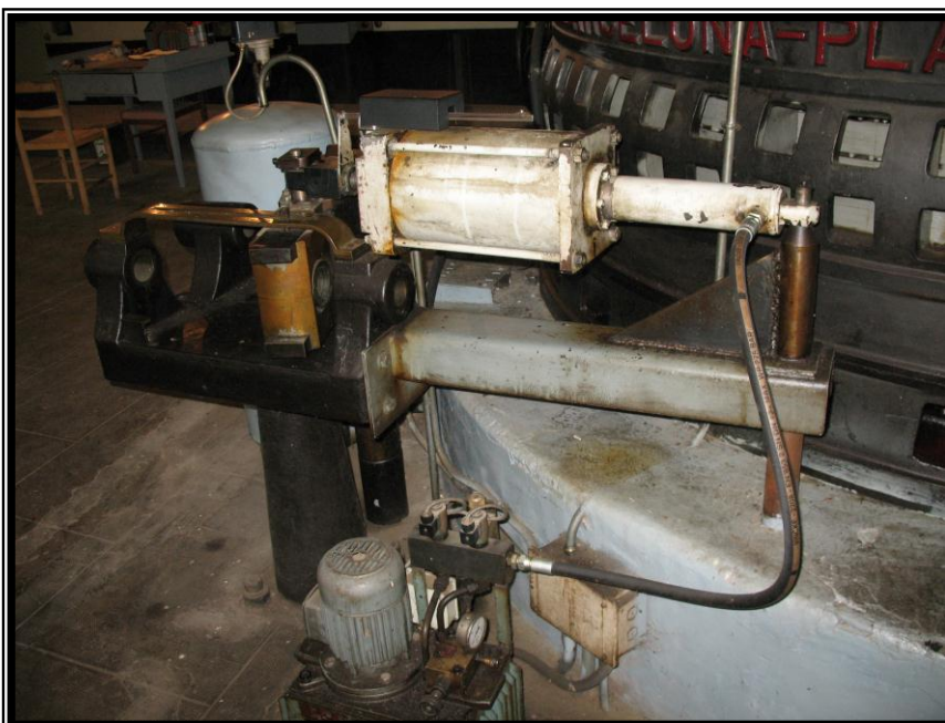
Sistema de pistons hidràulics que s'encarreguen de la posada en marxa/aturada de la turbina
