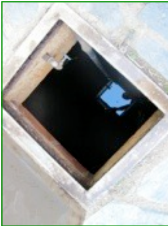
Dipòsit de l'aigua pluvial
