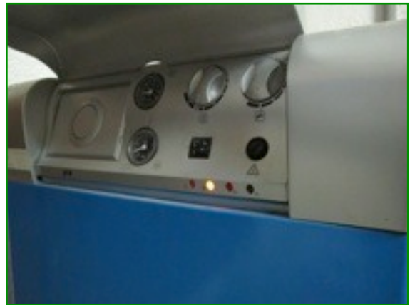
Caldera de gasoil
