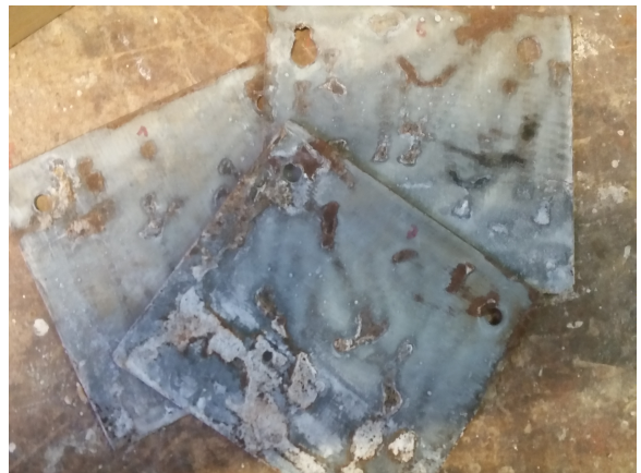
Il·lustració 24: Planxes de zinc, clarament deteriorades.
