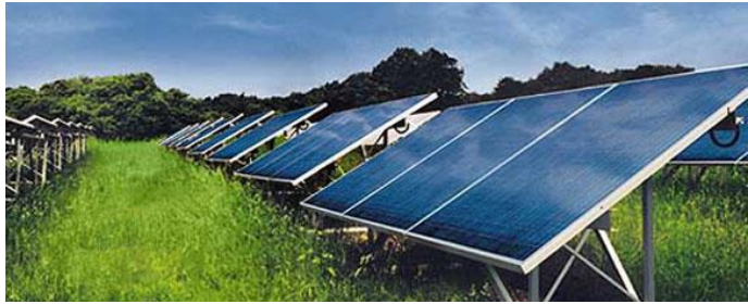
F11. Generadors fotovoltaics.
