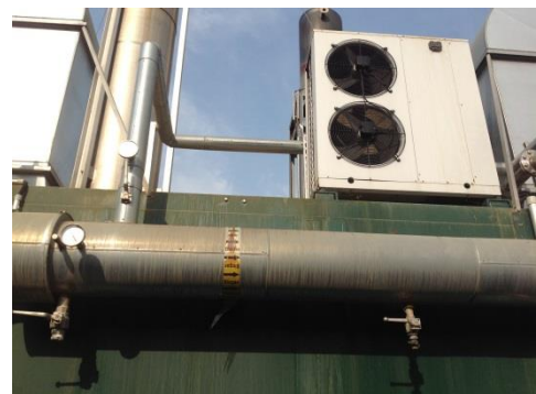
F34. Conductes i refrigeradors del gas.
