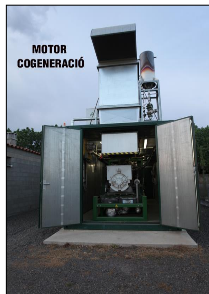
F37. Motor de cogeneració de la planta de biogàs de Cassà.
