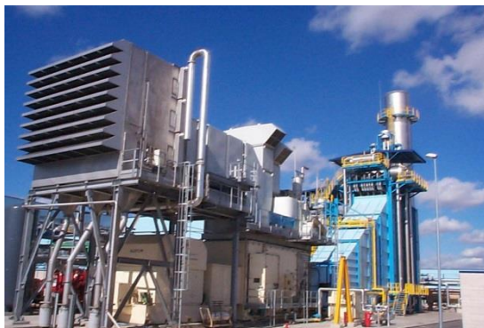
F15. Instal·lacions per a la generació d'electricitat.
