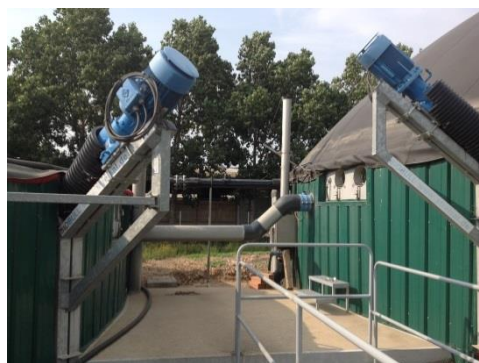
F23. Motors remenadors dels digestors.
