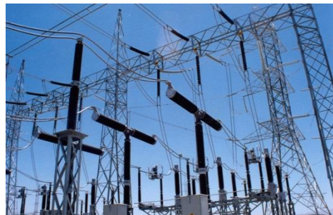
F39. Línies elèctriques.
