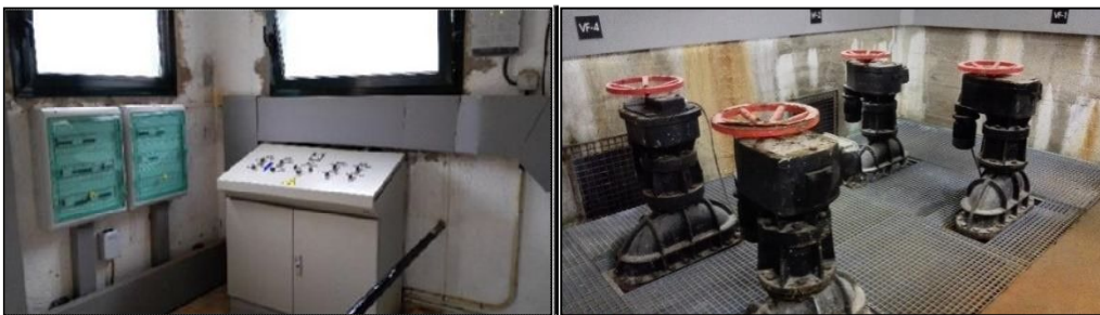
Comandament i vàlvules de la presa. Font: Marc Deu.
