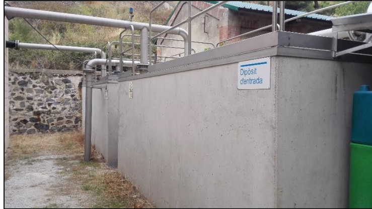
Dipòsits d'entrada i sortida de la planta d'osmosis. Font: Marc Deu
