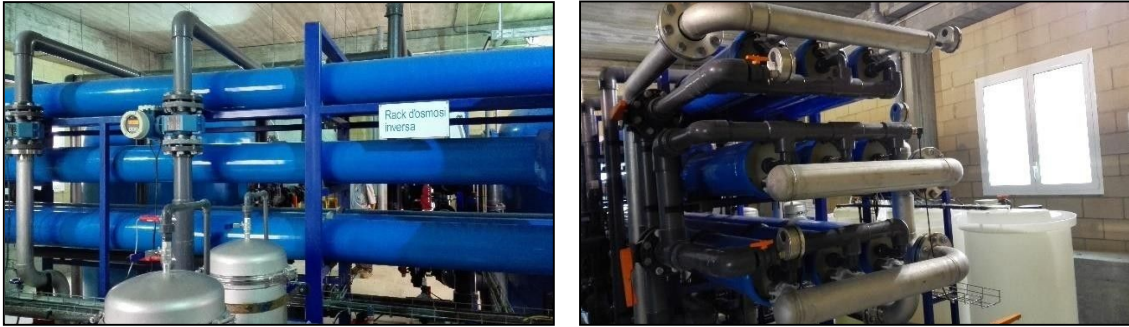
Filtres d'osmosis inversa. Font: Marc Deu
