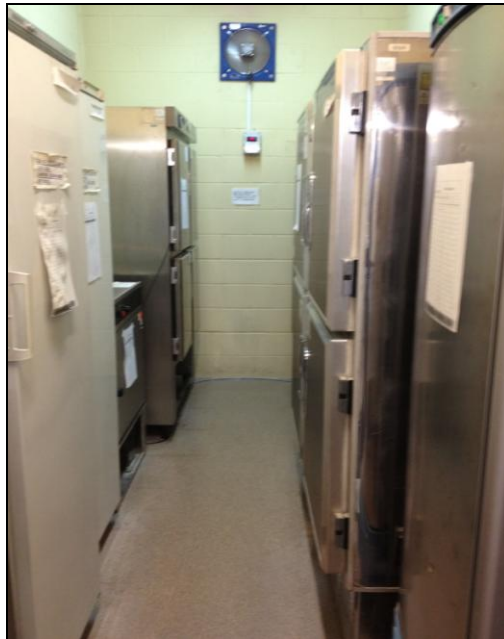
Imatge 37: Cambra de refrigeració
