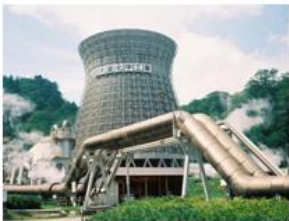
IMATGE 5: central geotèrmica
