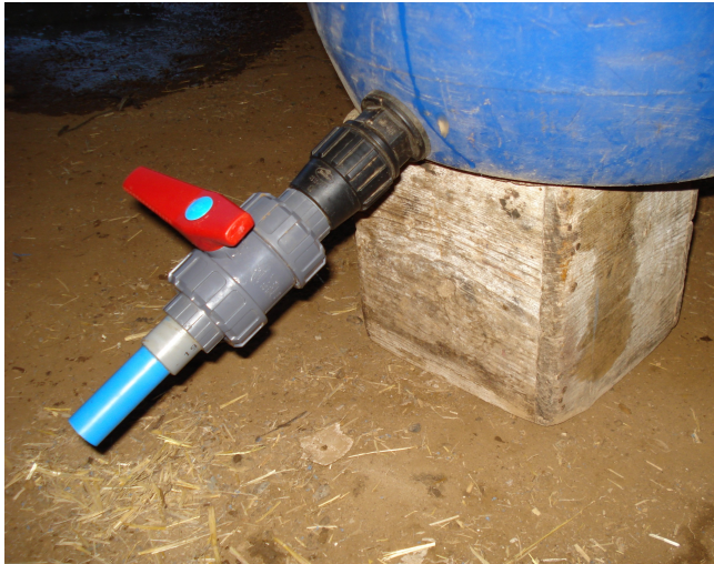
Aixeta buidat purí del digestor
