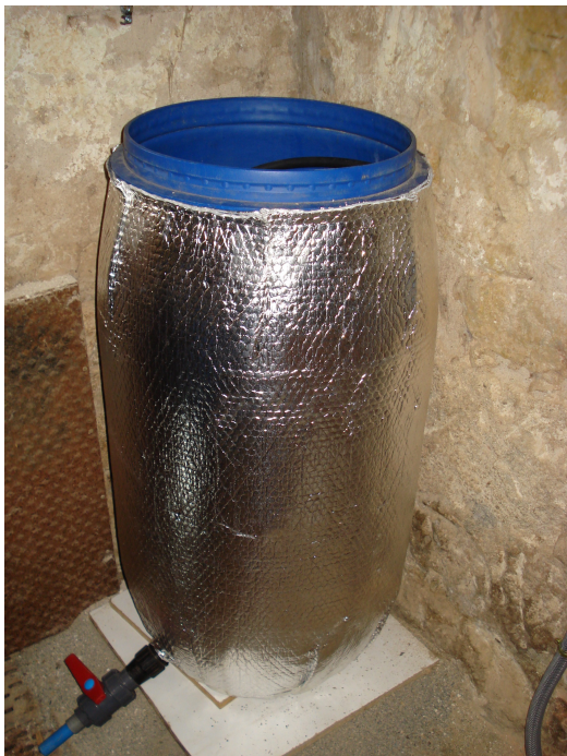
Aïllament del digestor
