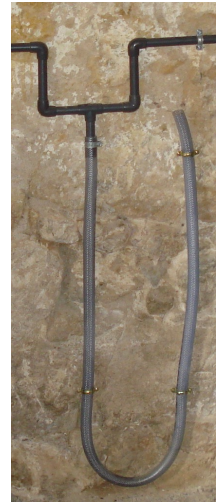
Trampa d'aigua i vàlvula de seguretat
