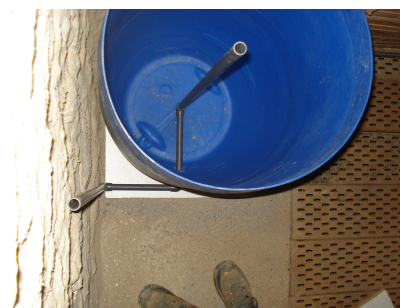
Entrada gas a l'acumulador
