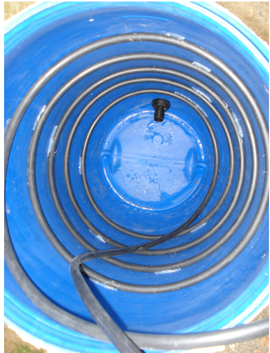
Serpentí interior del digestor
