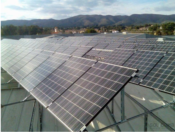
Instal·lació fotovoltaica formada per plaques convencionals de silici.
