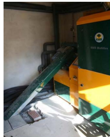
Imatge 38 Caldera de biomassa de l'escola bressol "el Rieral" 49
