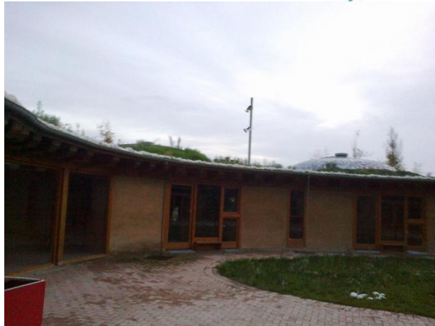
Imatge40. La coberta enjardinada connectada a través de canalitzacions que van a parar al dipòsit d'aigua 53
