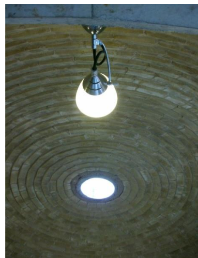
Imatge 13 Combinació de la il·luminació natural i artificial a l'escola bressol 14
