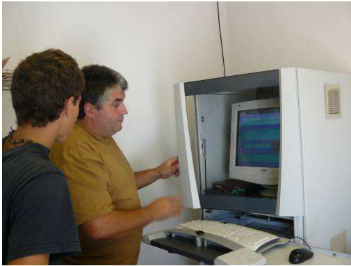
Fig. 76. Ordinador de la Subestació
