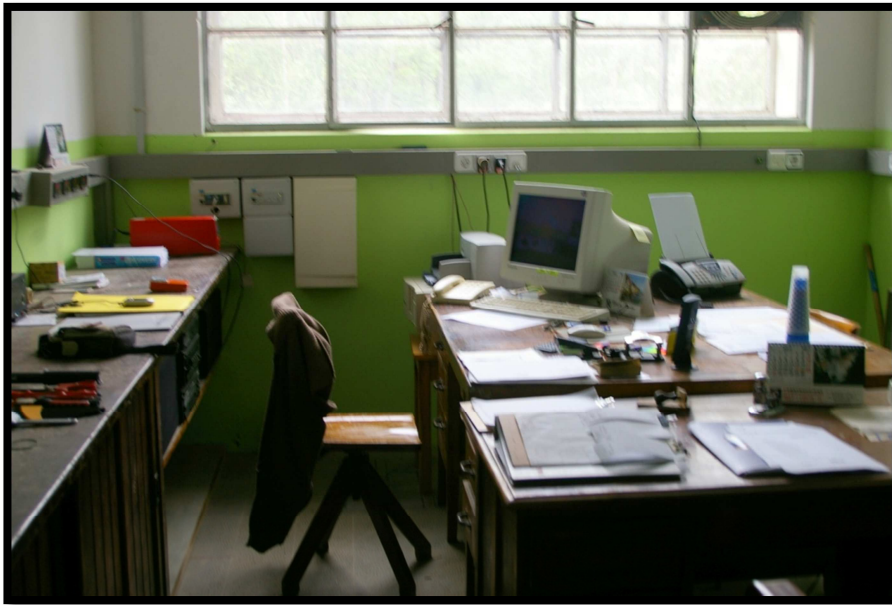
EL DESPATX: Des d'aquí es controla el bon funcionament de les dues turbines i és l'oficina.
