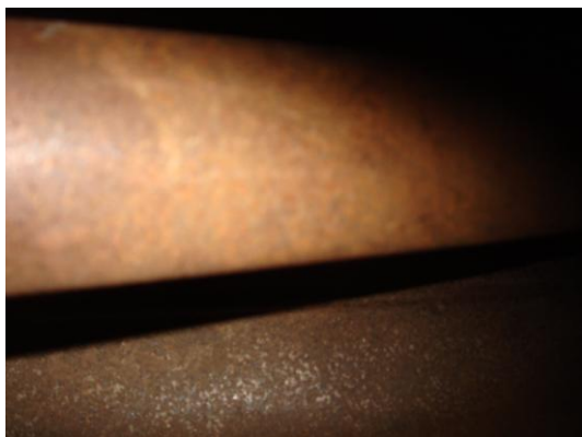
Foto 27: Òxid interior dipòsit
