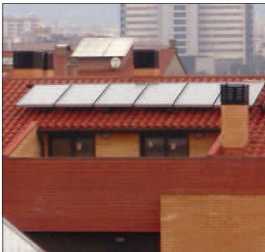
Edificio de viviendas, c/. Concepción Arenal (Barcelona) Instalador: Inbatesa
