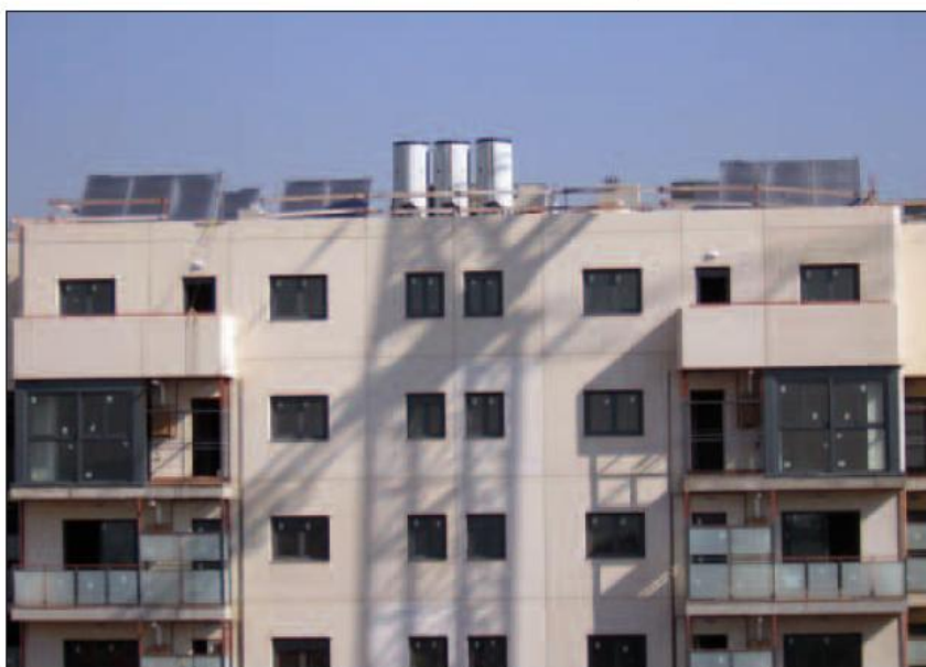
Edificios de viviendas en Barberà del Vallés (Barcelona) Instalador: Goval Instalaciones
