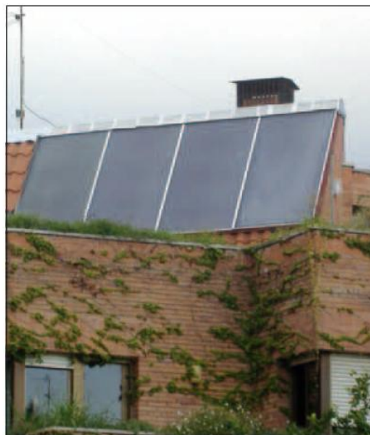
Vivienda unifamiliar en el Vendrell (Barcelona) Instalador: Colet Diu
