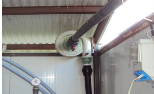
Figura 19. Ventilador per extreure el gas de l'interior del gasòmetre.
