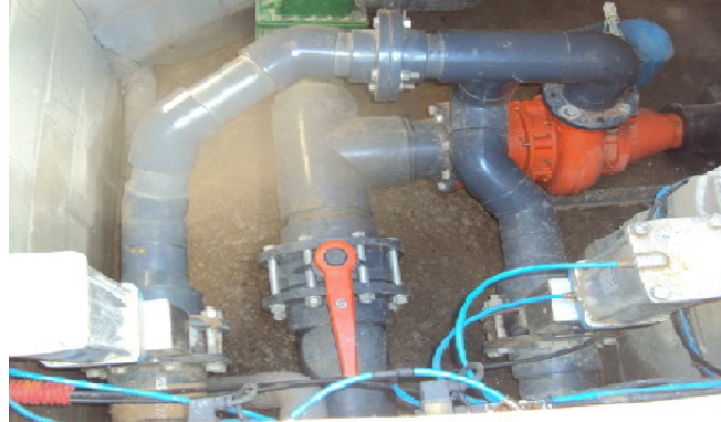
Figura 22. Electrovàlvules, controlen l'entrada i sortida del purí al digestor
