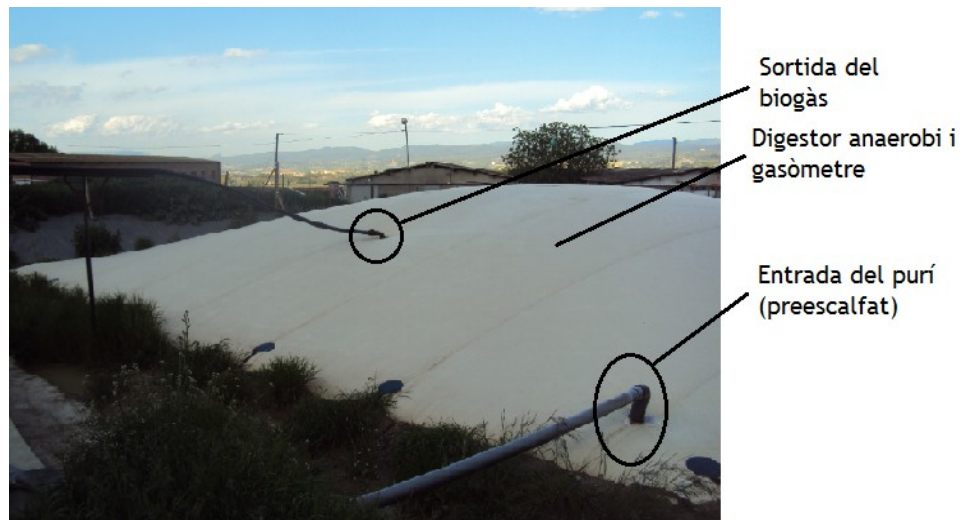
Figura 17. Digestor anaerobi enterrat (només visible el gasòmetre).
