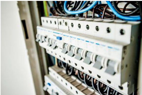
Imatge 11: Proteccions elèctriques
