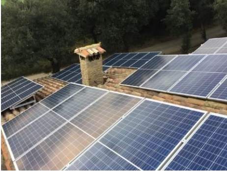
Imatge 10: Panells solars i suports
