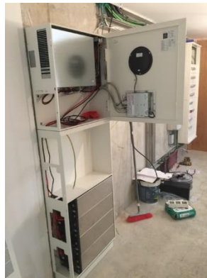
Imatge 7: Bateria oberta Sonnen
