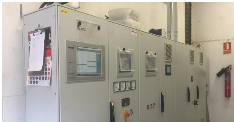
Figura 16. Sala de controls
