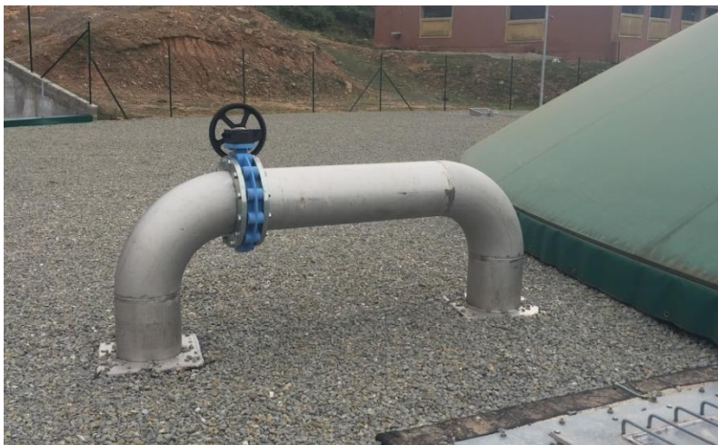
Figura 9. Pas del gas del dipòsit exterior al interior
