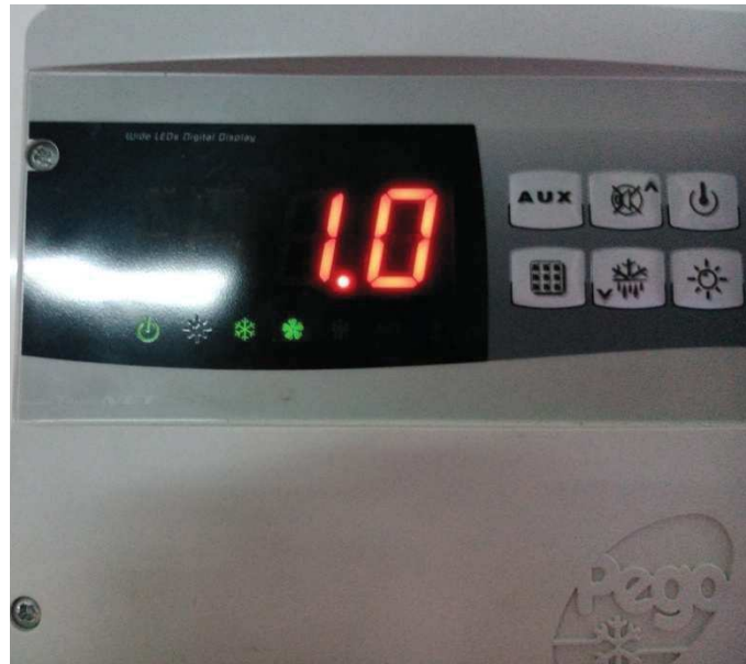
Imatge 62: temperatura de la darrera cambra de refrigeració
