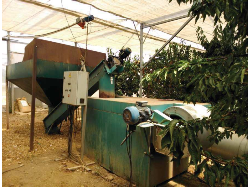
Imatge 43: caldera de biomassa de la qual surt un tub de calefacció
