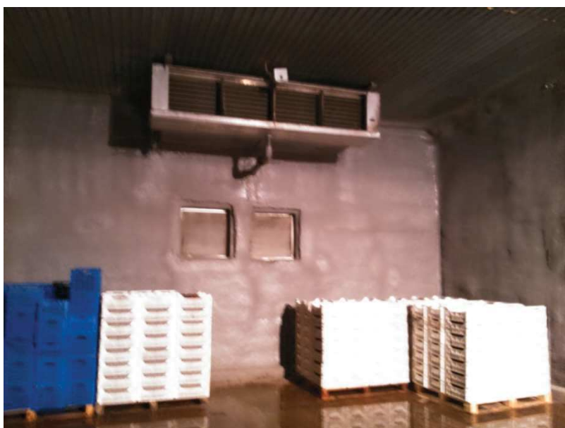
Imatge 54: cambra frigorífica on s'emmagatzemen les cireres que arriben del camp
