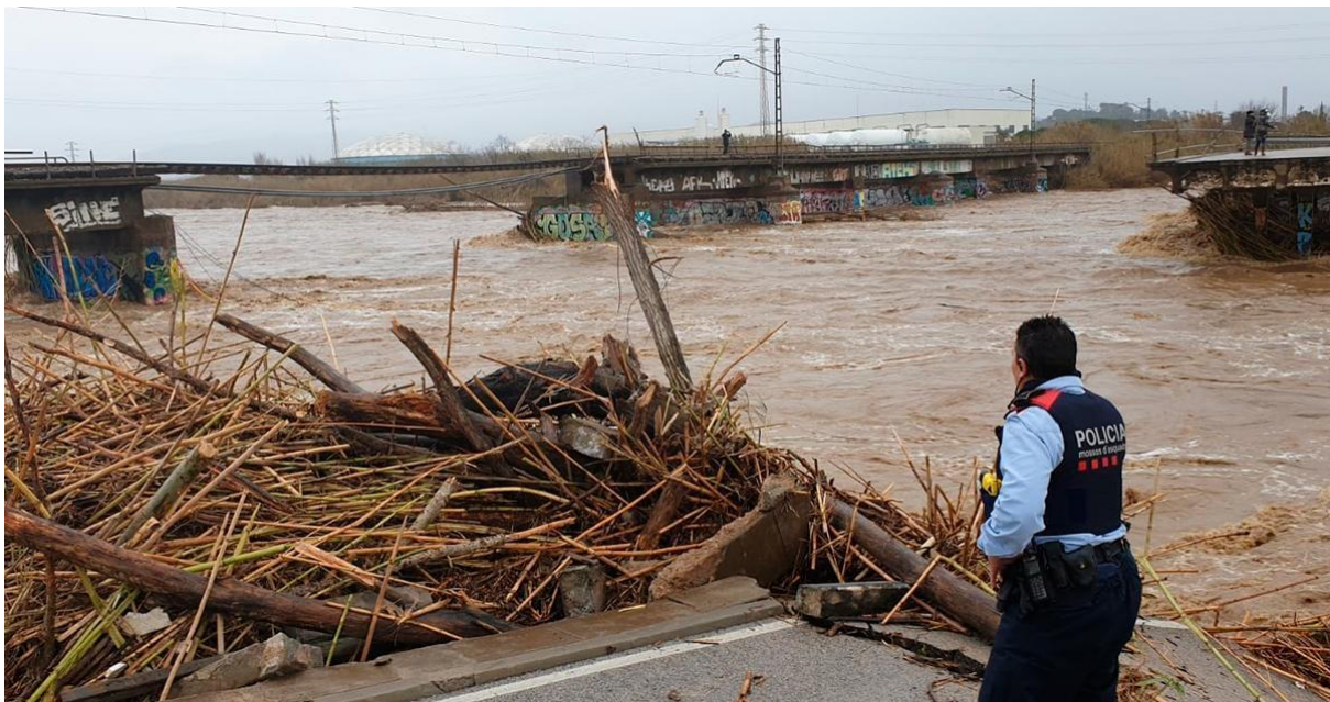
Figura 31: La Tordera arrossega el pont del ferrocarril de la línia de rodalies R1 el dimecres 22 de 2020 (Mercader, 2020)
