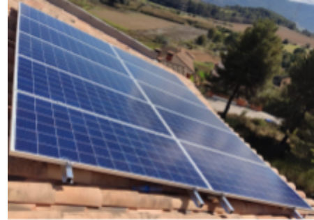
Font 36: Placa solar fotovoltaica
