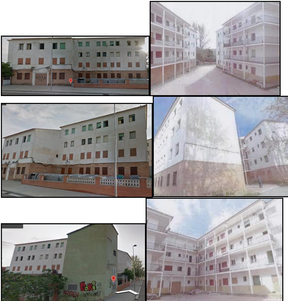
Figures 2.3, 2.4, 2.5, 2.6, 2.7, 2.8. Fotos de l'estat actual de l'edifici. Fonts: Giese Ventas i Google Maps.
